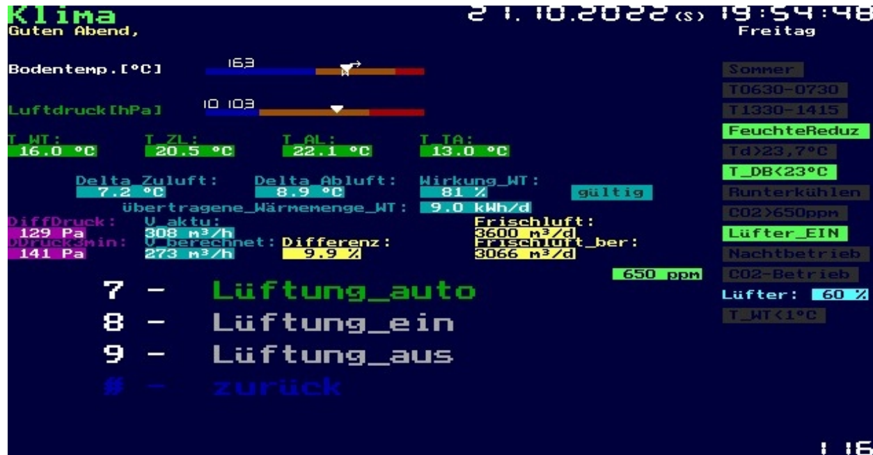
Lüftungsanlage im Oktober in Funktion, angezeigter Wirkungsgrad Wärmetauscher: 81%
