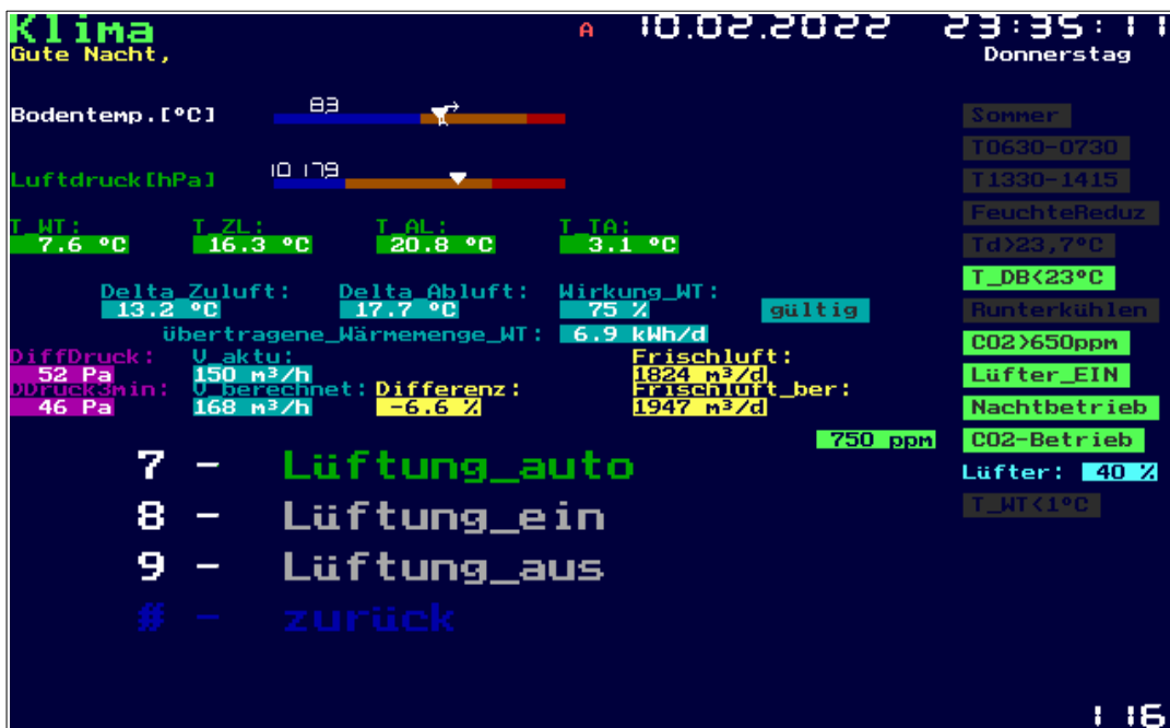
Klima-Seite 116 im Regelbetrieb. Wärmetauscher mit äußerem und innerem Labyrinth.
